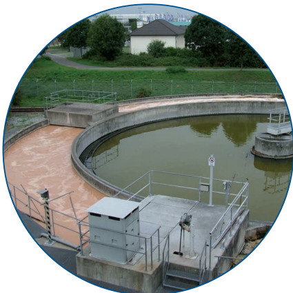
Fig. 1: Tanque de oxidação com tanque central de deposição final
